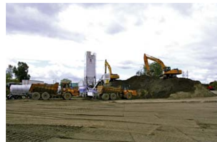
Projet de réhabilitation d'un site industriel contaminé au zinc utilisant la technique de solidification et stabilisation au ciment.
